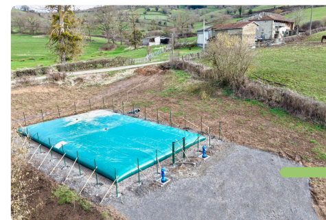
Réserve d'eau en cas d'incendie, à Chavannes
